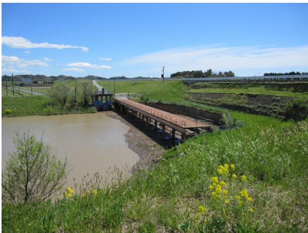
▲吉田川サイフォン入り口（鶴田川が右側の吉田川堤防の下をくぐる）
